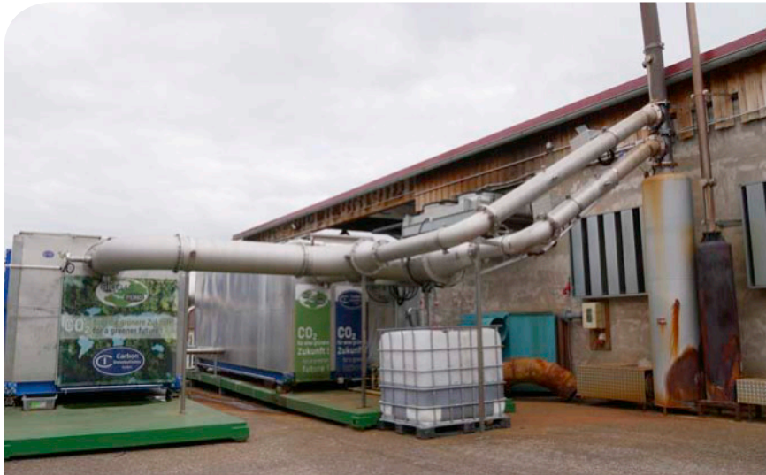
Anlagen-Ansicht von vorne. Im grauen Behälter links befindet sich der Staubfilter.
