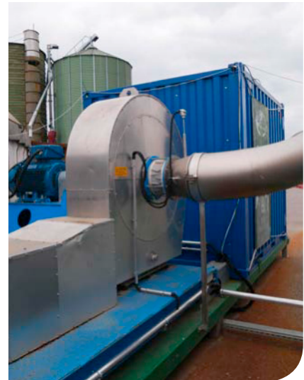
Der Ventilator, der das Abgas durch die Kammern saugt. Laut van Bree sei er zwar groß, laufe aber relativ langsam und habe deshalb einen geringen Strombedarf.
